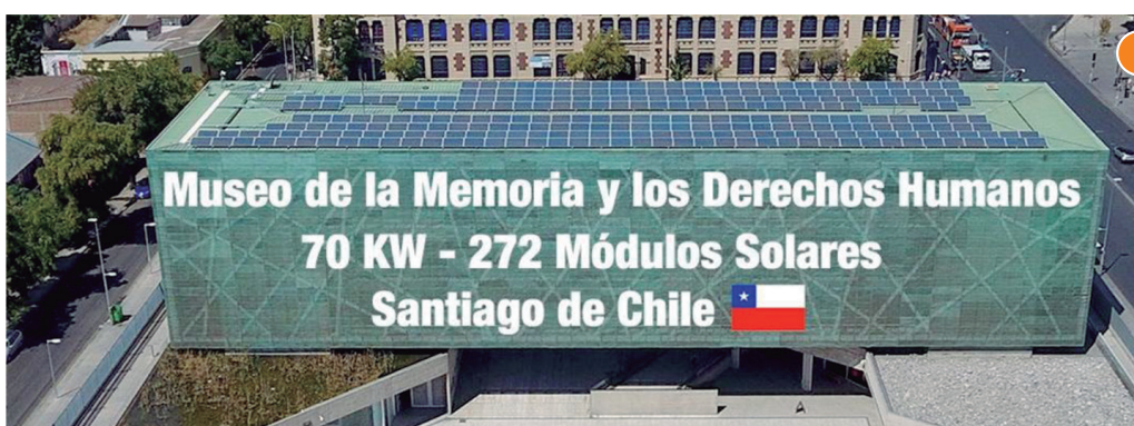
70 kWp Photovoltaik-Anlage auf dem Museo de la Memoria y los Derechos Humanos in Santiago
