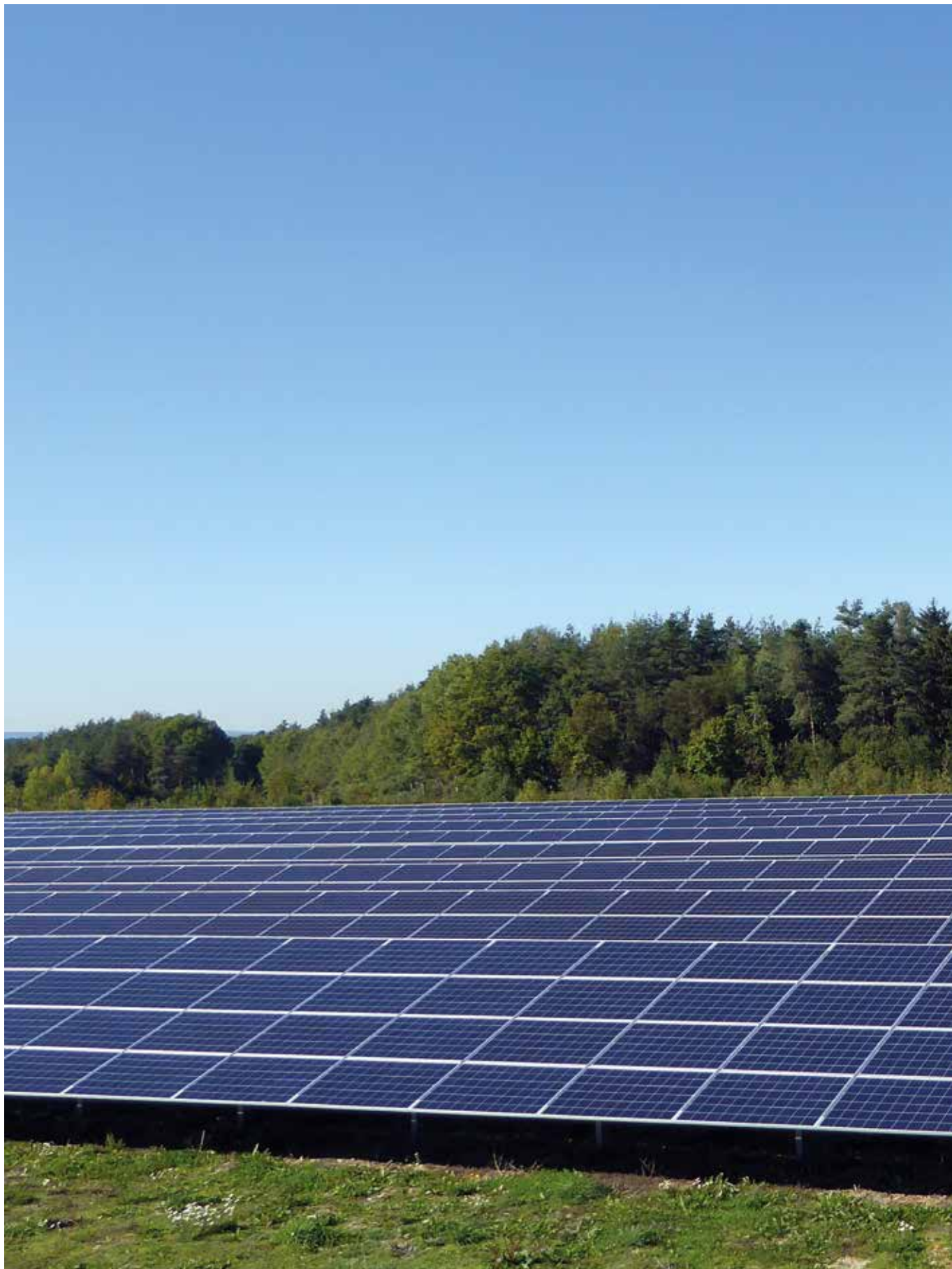
Freiflächen-Anlage Hofmann Ebermannsdorf
