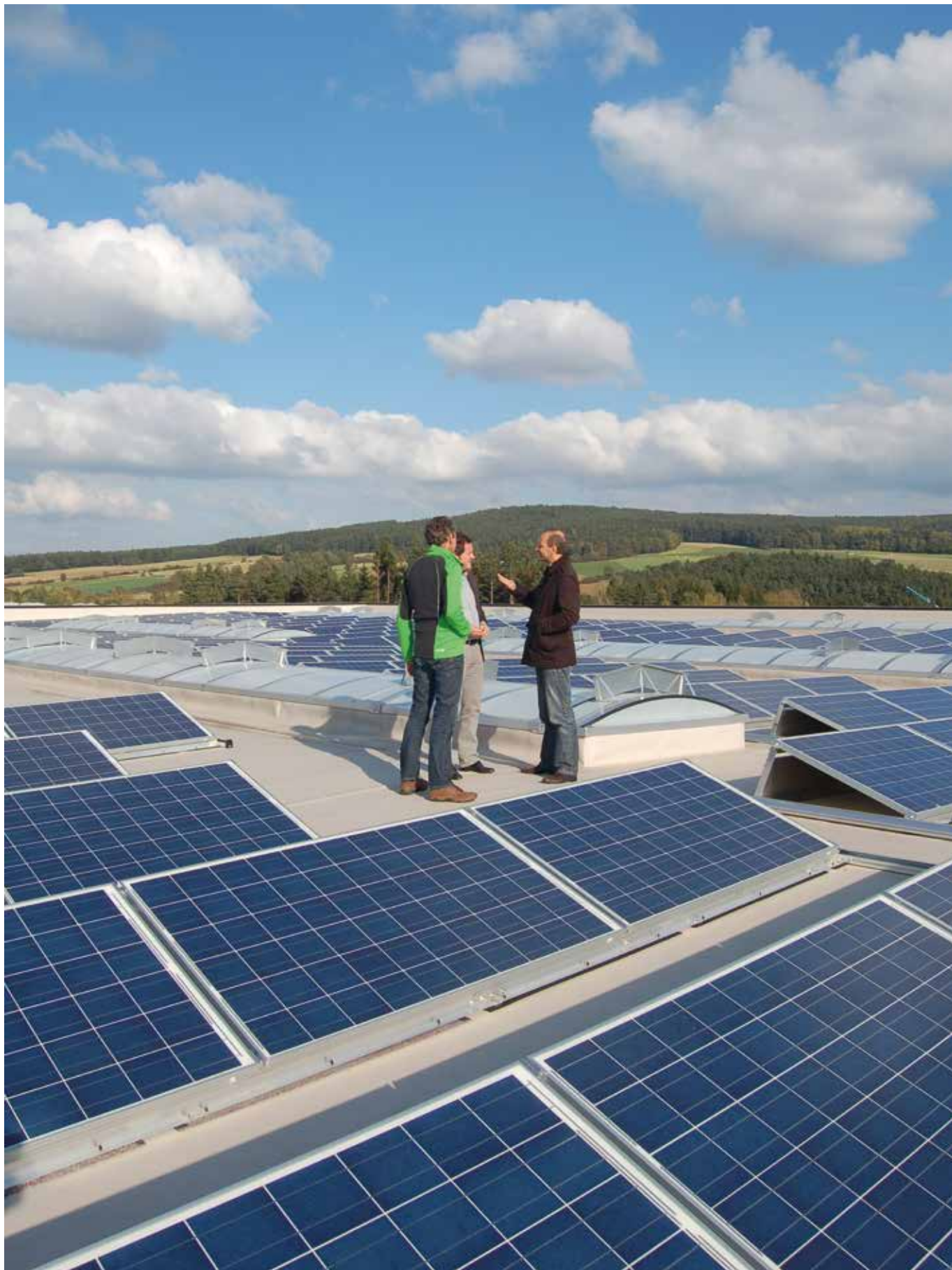
SolarStrom-Anlage baumann automation Amberg
